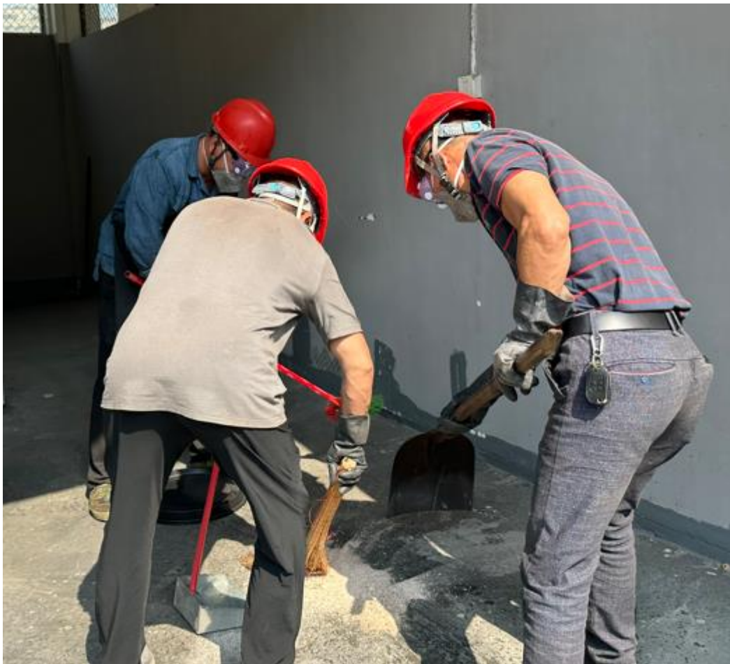
安排人员对泄漏区域警示围挡，并进行清扫。
